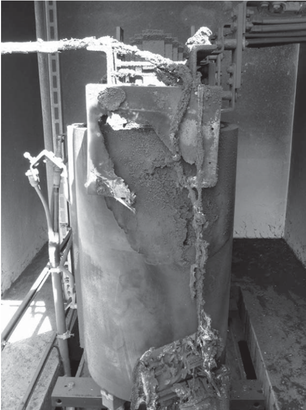
Bild 2.9 Schaden an einem Mittelspannungstransformator am 26. September 2006
